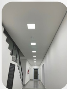
Forro em Drywall
